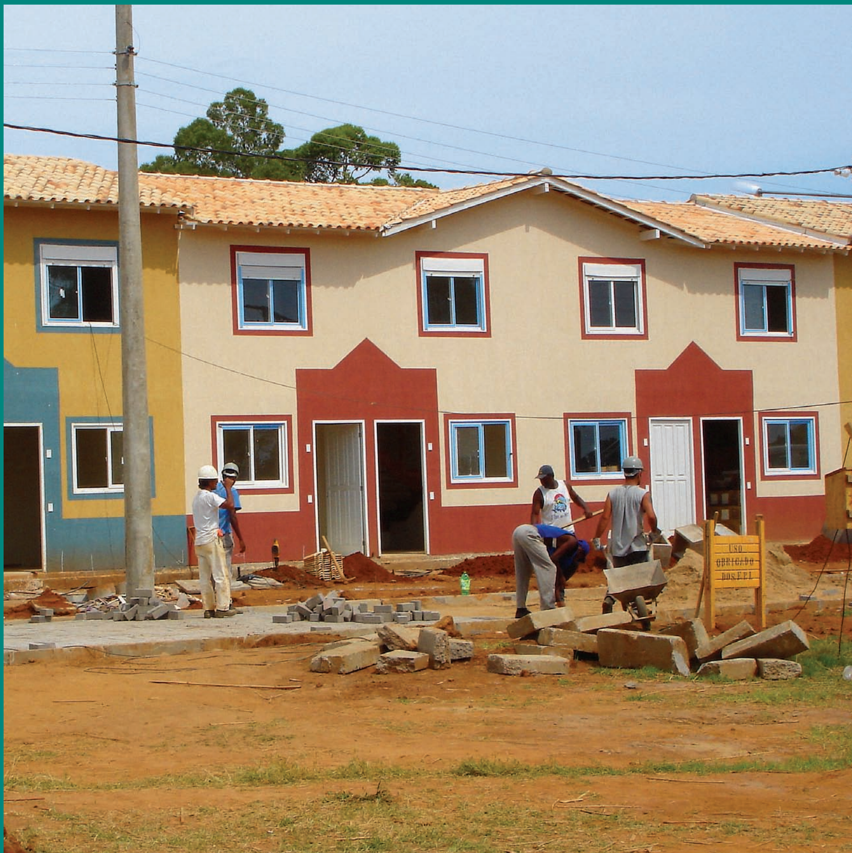
Esporte e Vida, Condomínio Gravataí, Rio Grande do Sul | Sport and Life, Gravatá Condominium, Rio Grande do Sul
